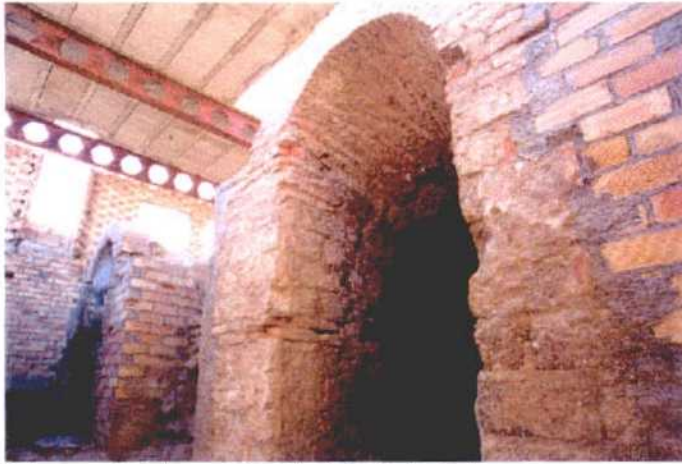
Pobre aspecto de la reconstrucción de los baños árabes
